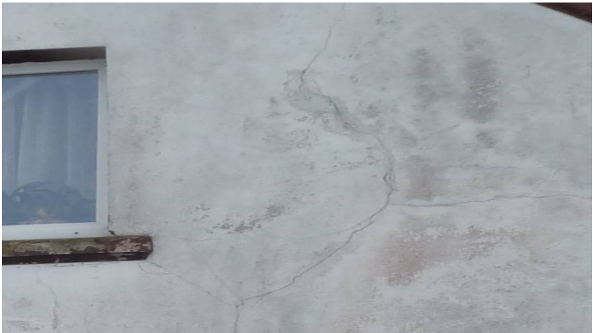
Zdj. 4 Widok zarysowań i siatka spękań tynku w wyniku wpływu ruchu fundamentów i czynników atmosferycznych
