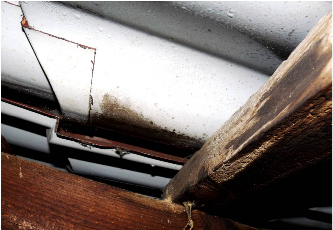
Zdj. 14 widoczne krople rosy na blachodachówce i zbutwiała łąta
