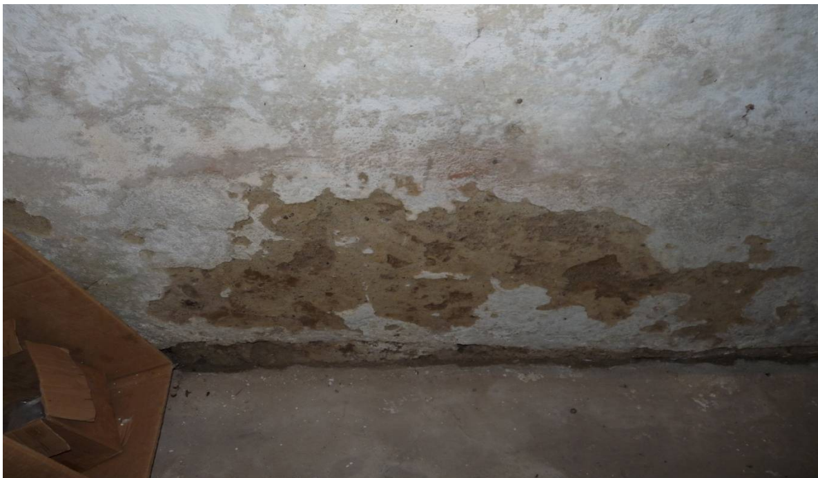
Zdj. 3 Widok zawilgocenia ściany fundamentowej wewnętrznej zawilgoconej i złuszczenia tynku
