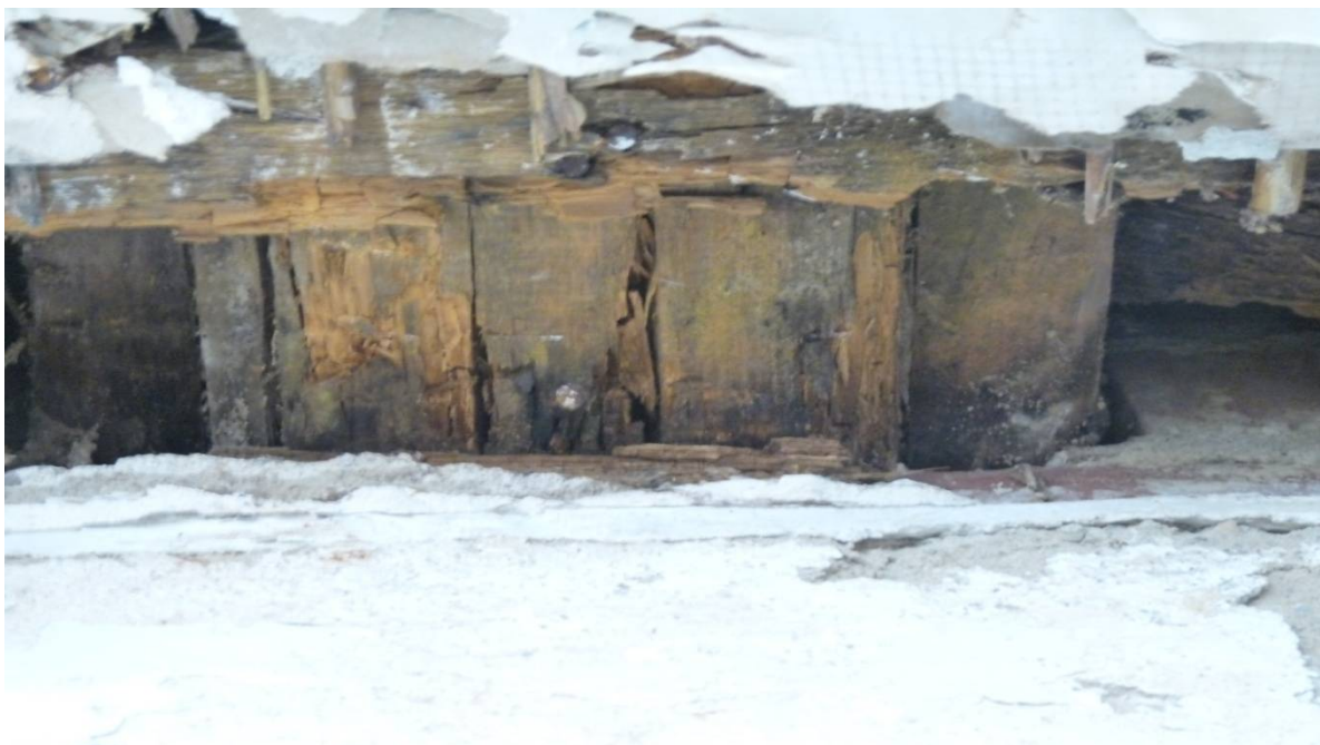
Zdj. 7 Zbutwienie belki stropowej w miejscu długotrwałego przecieku z łazienki
