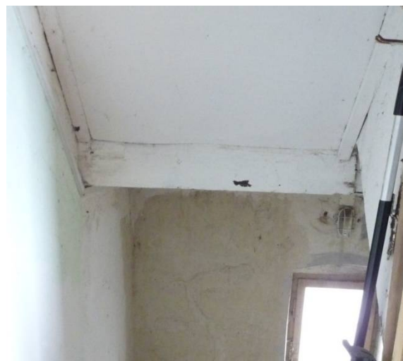
Zdj. 16 Belka podestowa spocznika
