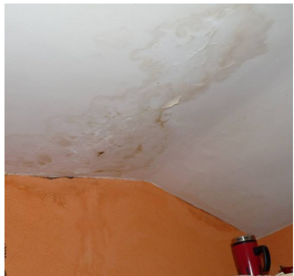
Zdj. 13 Przecieki z dachu
