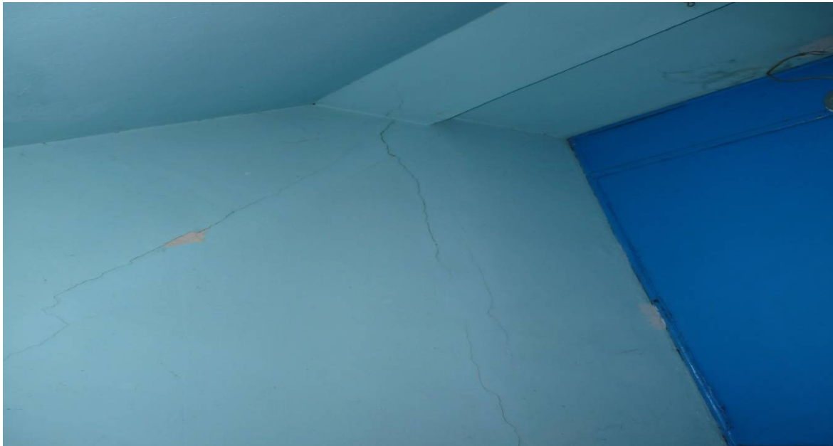
Zdj. 5 Widok zarysowania ściany klatki schodowej w okolicy oparcia płatwi na murze
