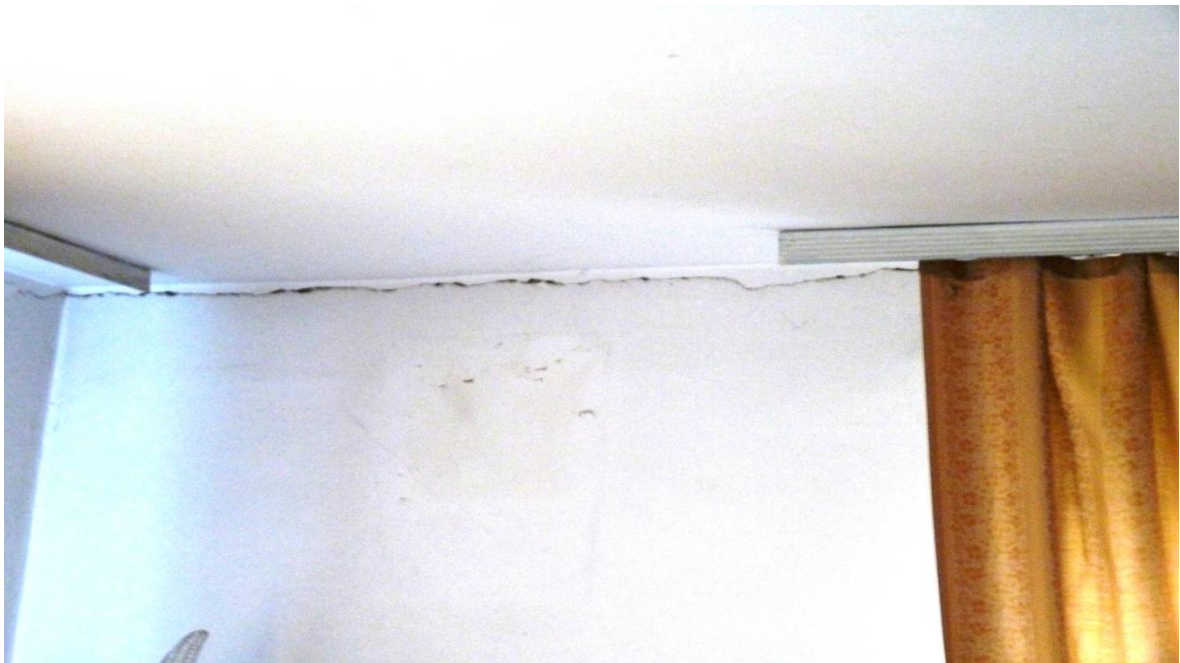
Zdj. 6 Widok przemieszczenia ścianki względem stropu (osiadanie ściany zewnętrznej)
