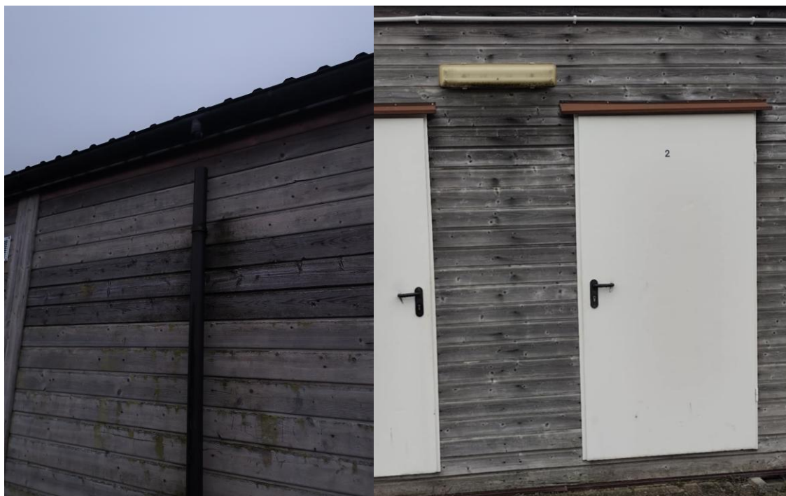
Fot.6. Widok na stan orynnowania budynku szatniowego i stan kloszów lamp zewn. / fot. Dzięki uprzejmości UG. Dygowo
