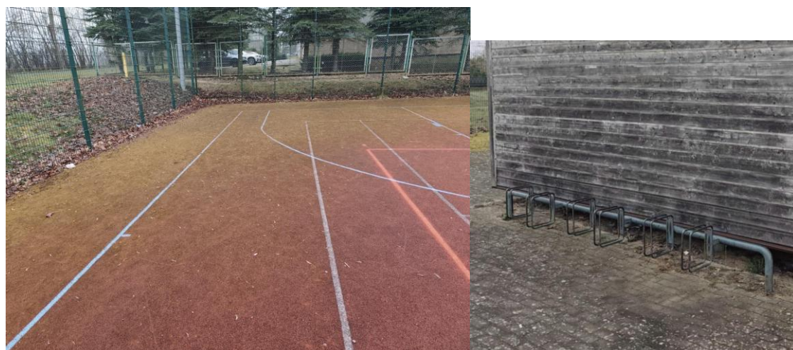
Fot.2. Widok na zużytą nawierzchnię poliuretanową boiska wielofunkcyjnego oraz stan stojaków rowerowych/ fot. Dzięki uprzejmości UG. Dygowo
