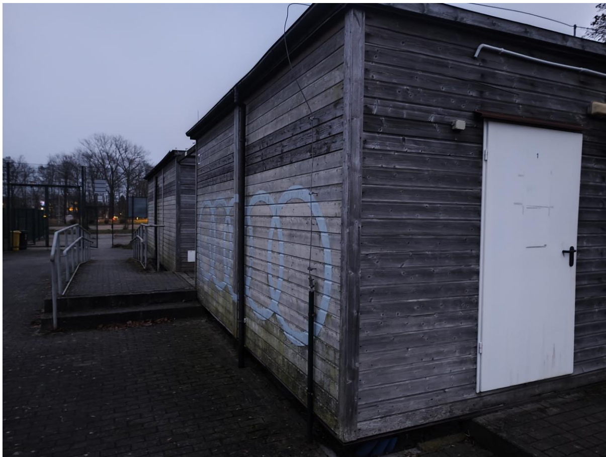
Fot.3. Widok na jeden z budynków szatni sportowej i zużycie materiału elewacyjnego i drzwi zewn./ fot. Dzięki uprzejmości UG. Dygowo
