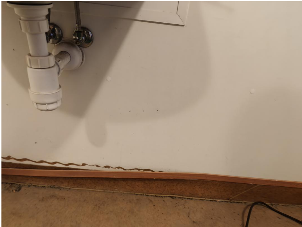
Fot.5. Widok na zużyte listwy przypodłogowe w pomieszczeniach budynku szatniowego. / fot. Dzięki uprzejmości UG. Dygowo
