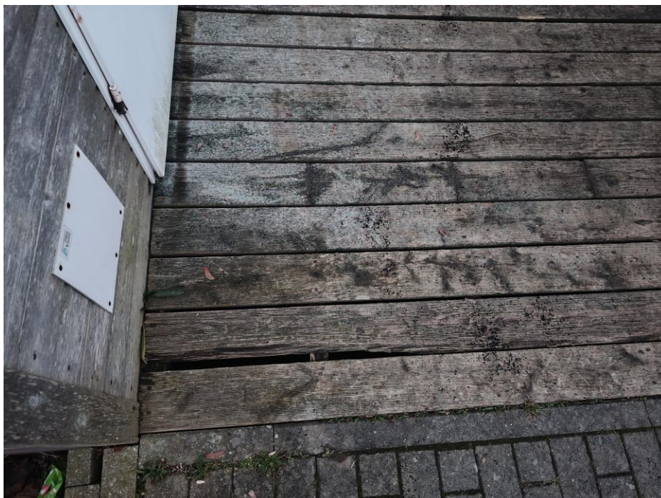
Fot.4. Widok na zużytą nawierzchnię drewnianą podestu łączącego oba budynki szatni sportowej. / fot. Dzięki uprzejmości UG. Dygowo
