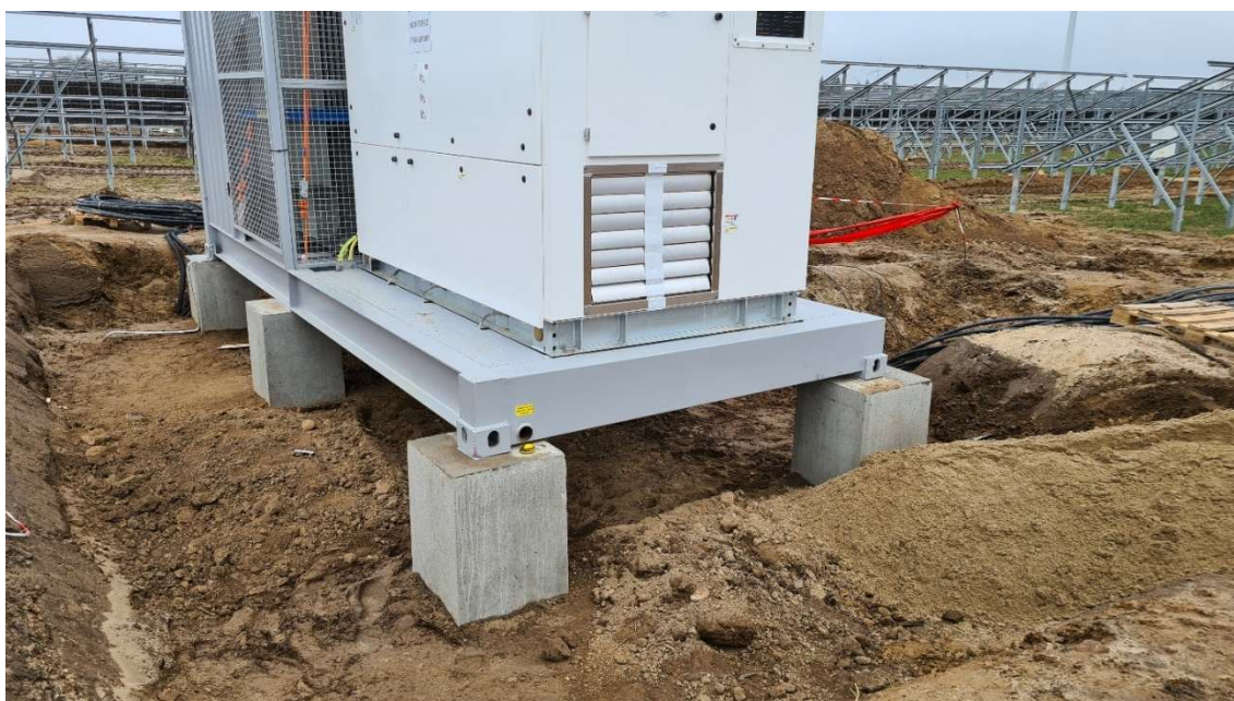
Zdjęcie 18. Przykładowy fundament pod stacją – etap budowy (zdjęcie wykonane przez autora prognozy)
