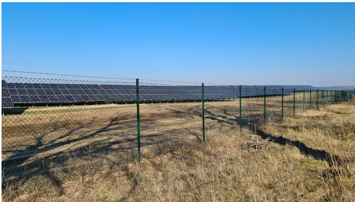
Zdjęcie 22. Przykład farmy fotowoltaicznej (zdjęcie wykonane przez autora prognozy)
