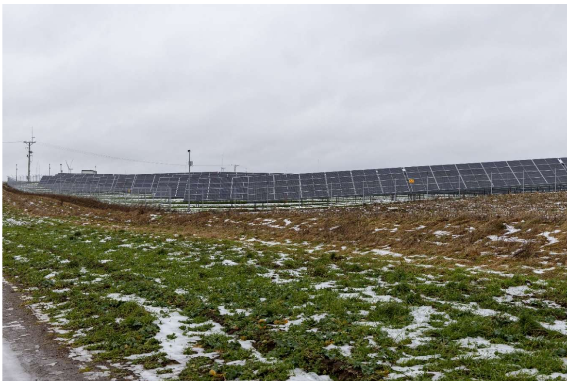
Zdjęcie 23. Przykład farmy fotowoltaicznej (zdjęcie wykonane przez autora prognozy)
