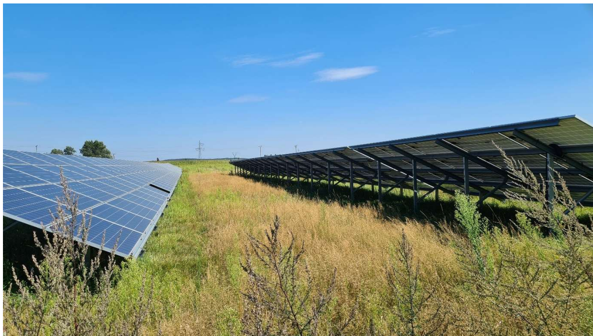
Zdjęcie 15. Przykład szaty roślinnej między panelami fotowoltaicznymi (zdjęcie wykonane przez autora prognozy)
