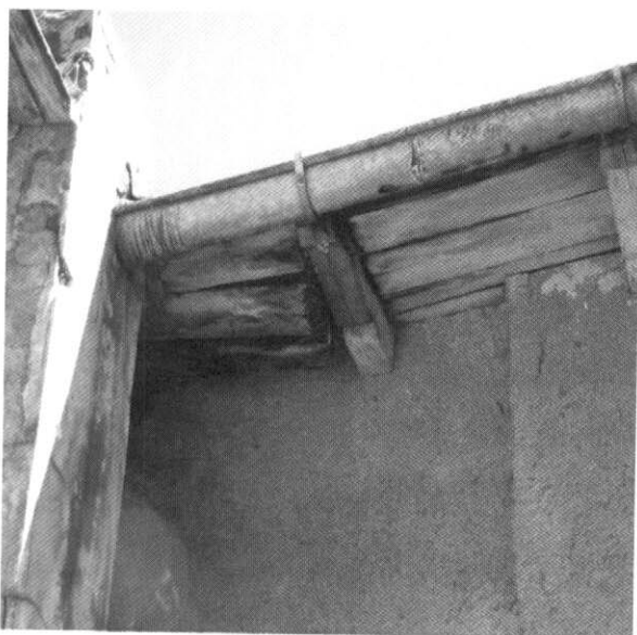
zdj.8 widok zbutwienia krokwi od strony ściany
