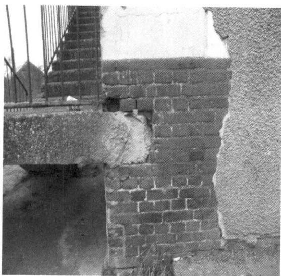
zdj. nr 5 Widok zarysowania ściany narożnika
