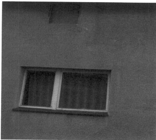
zdj. nr 3 Widok osiadłego narożnika od str. południowo-wschodniej
